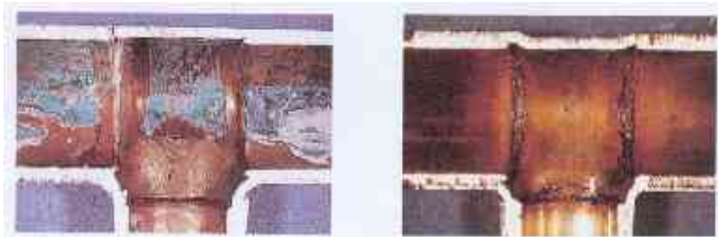
gelötet mit Flussmittel der alten Generation (zu hohes Metall- und Ammoniumchlorid) gelötet mit LAVAR-21 (F-SW21 / DIN 8511)
